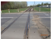
Stan nawierzchni na przejeździe
