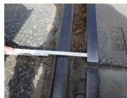
Zanieczyszczone zone żłobki
