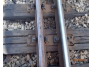
Stan techniczny podrozdzi c w rozjeździe nr 8 i podkładów na wstawce między rozjazdami 8 i 9 na stacji Czeremcha
