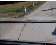
Stan techniczny płyt przejazdowych i drogi na podjeździe przejazdu kat. „D” linii nr 31 Siedlce - Siemianówk a. Widok zaniżonych płyt środkowych przejazdu
