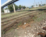
Stan techniczny podkładów w torze nr 2 na stacji Czeremcha, obok stan wymienny ch podkładów
