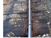
Stan techniczny podrozdzi c w rozjeździe nr 8 i podkładów na wstawce między rozjazdami 8 i 9 na stacji Czeremcha
