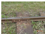
Nieprawidłowa, krótka wstawka szynowa, brak śrub łubkowych.
