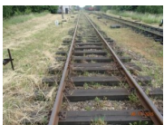
Braki w podsypce, odsłonięte czoła podkładów.
