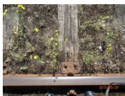
Stan podkładów drewnianych w torach normalnotorowych nr 1 i 2 na stacji Siemianówk a.
