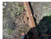
Widok toru szerokotorowego nr 109 na stacji Siemianówk a. Tor zarosnięty, zły stan techniczny podkładów drewnianych.
