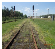
Widok toru szerokotorowego nr 109 na stacji Siemianówk a. Tor zarosnięty, zły stan techniczny podkładów drewnianych.
