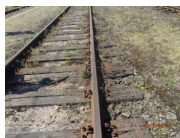
Stan podkładów drewnianych w torach normalnotorowych nr 1 i 2 na stacji Siemianówk a.
