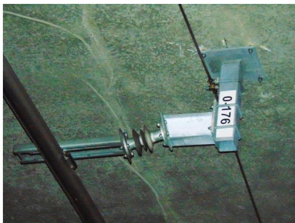
Zdjęcie 93. Widok podwieszenia górnej sztywnej sieci trakcyjnej
