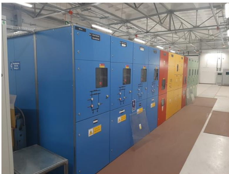
Zdjęcie 65. Widok rozdzielnicy prądu stałego o napięciu 3 kV
