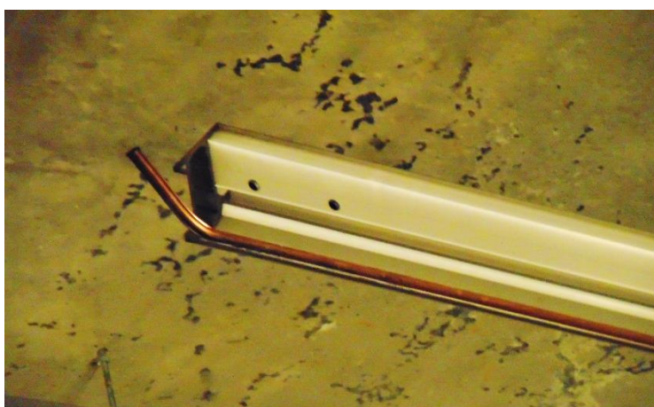
Zdjęcie 91. Widok zakończenia profilu nośnego w górnej sztywnej sieci trakcyjnej wraz z założonym drutem jezdnym w rozjeździe sieciowym
