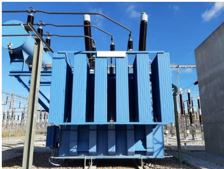
Zdjęcie 69. Widok transformatora trakcyjnego 400 kV/2x27,5 kV w podstacji trakcyjnej systemu 2x25 kV 50 Hz
