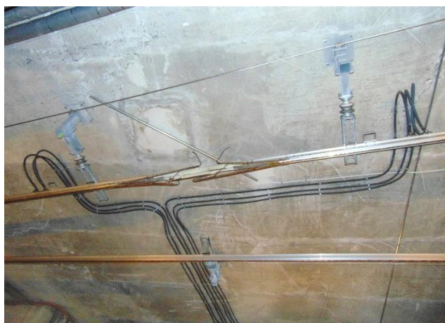
Zdjęcie 94. Widok połączeń prądowych w górnej sztywnej sieci trakcyjnej do odłącznika sekcyjnego
