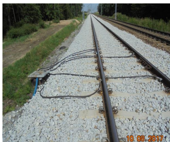
Zdjęcie 86. Dławik torowy wraz z torowymi połączeniami elektrycznymi
