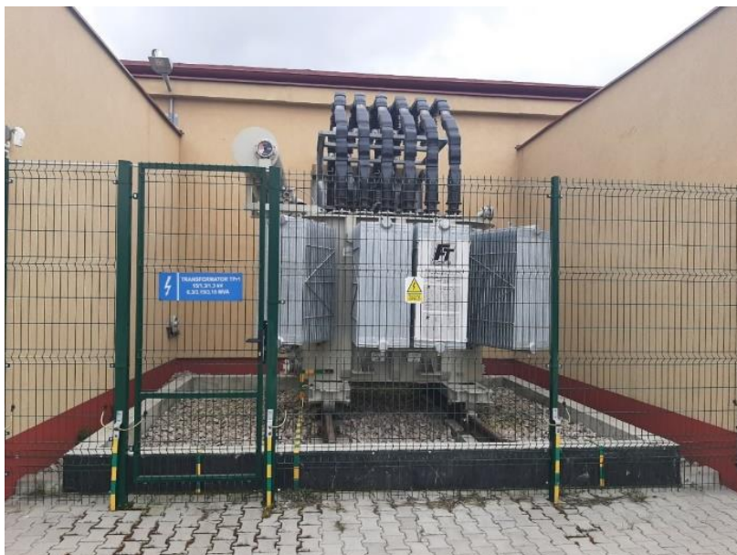
Zdjęcie 64. Widok stanowiska transformatora prostownikowego z transformatorem prostownikowym o mocy 6,3 MV·A
