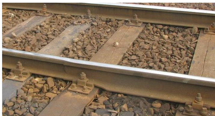
Zdjęcie 16. Szyna przejściowa
