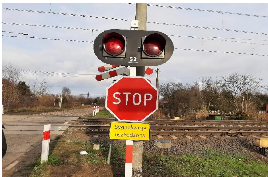
Zdjęcie 4 – Oznakowanie przejazdu po przyjeździe przedstawicieli PKBWK
