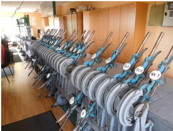
Urządzenia mechaniczne scentralizowane – ława nastawcza, dźwignie zwrotnicowe i wykolejnicowe
