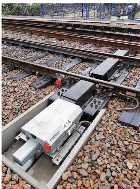
Zdjęcie 30. Elektryczny napęd zwrotnicowy typu EBI Switch
