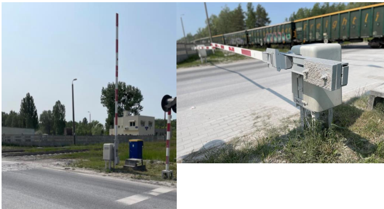
Zdjęcie 65. Elementy systemu urządzeń zabezpieczenia ruchu na przejeździe kolejowo-drogowym
