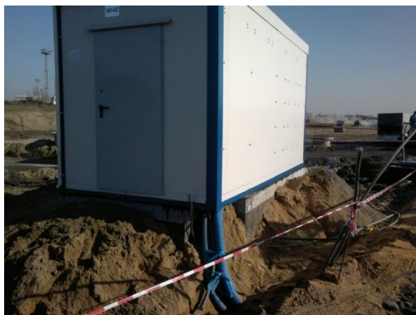
Zdjęcie 72. Przykładowy kontener technologiczny SRK po posadowieniu na fundamentie
