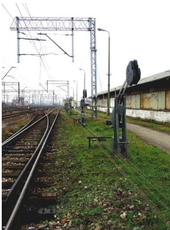
Zdjęcie 34. Widok zewnętrznych naprężaczy pędni drutowej z ciężarami żeliwnymi
