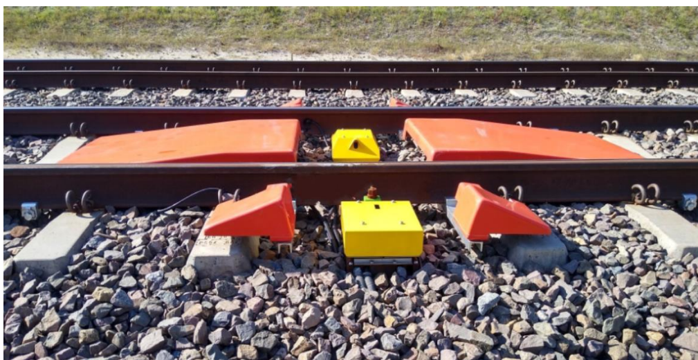
Zdjęcie 68. Urządzenie dSAT zainstalowane na torach
