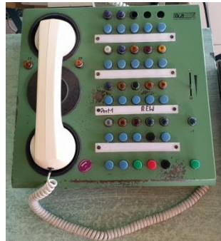
Szafa centralki zapowiadawczej
