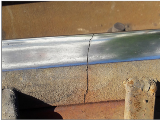
Zdj.1. Pęknięcie szyny.
