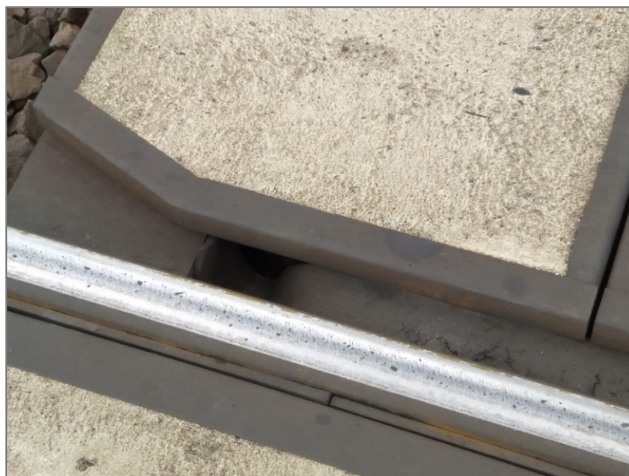
Zdj.12. Ubytki nawierzchni przejazdu
