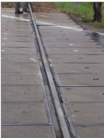
Zdj.11. Przesunięcia płyt
