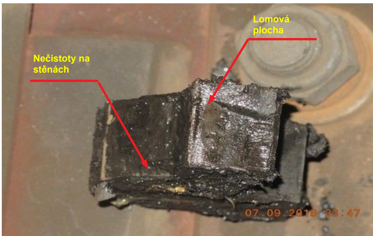
Obr. č. 13: Pohled na nečistoty na povrchu zlomeného závěrového háku pravého vnitřního ohnutého jazyka čelistového výměnového závěru výhybky č. 169a a pohled na lom po vzniku MU Zdroj: DI
