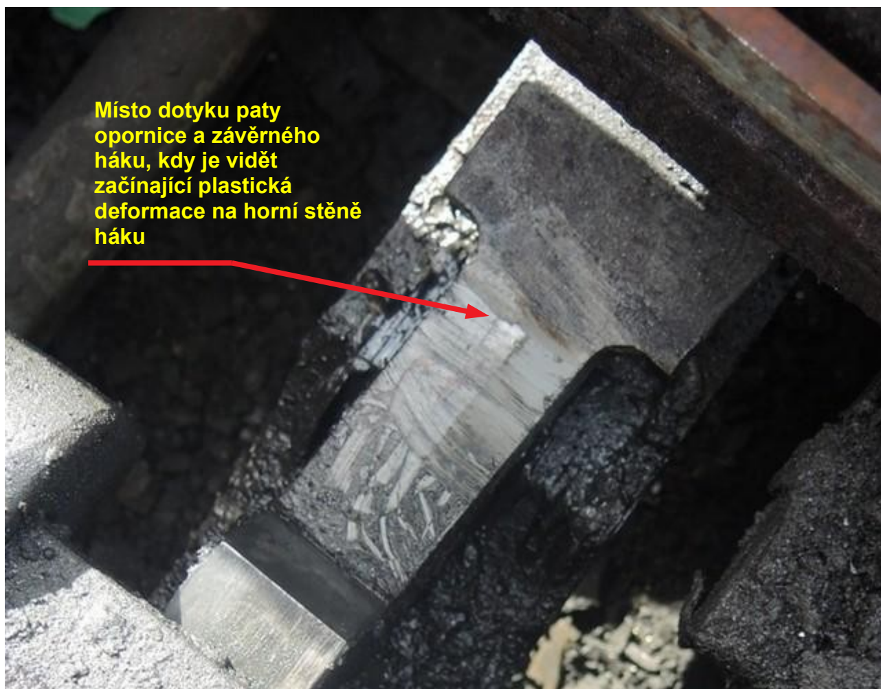
Obr. č. 25: Pohled na horní stěnu závěrového háku pravého vnitřního ohnutého jazyka na výhybce č. 169a za provozu Zdroj: DI
