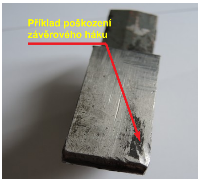
Obr. č. 17: Příklad poškození horní stěny závěrového háku z výhybky č. 169a Zdroj: DI
